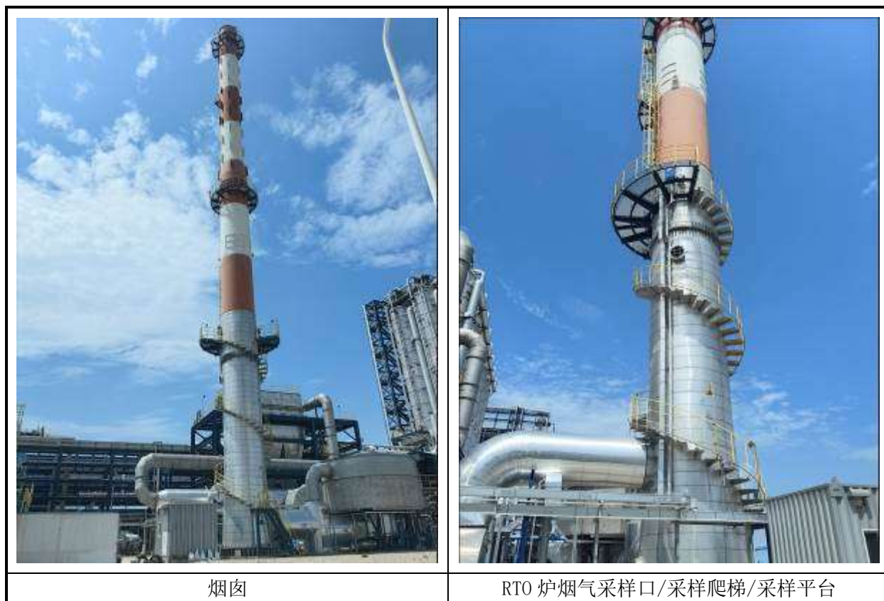
图 4.1-4 本装置废气焚烧炉现场照片
