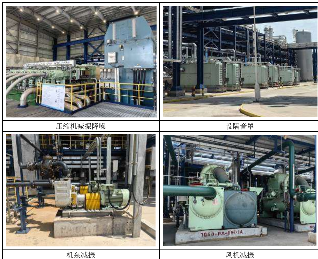
图 4.1-5 本装置噪声治理设施现场照片
